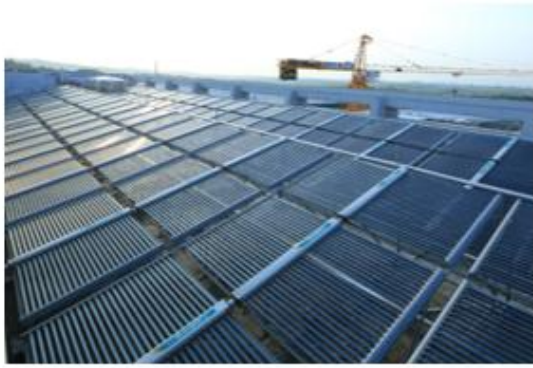
屋面集热器现场照片
