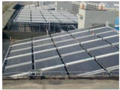
屋面集热器现场照片
