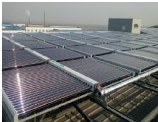
屋面集热器现场照片
