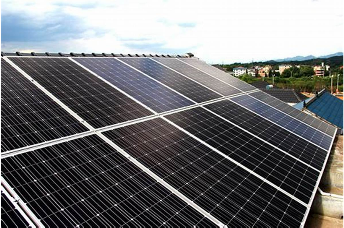
图 2.4-1 屋顶分布式光伏项目
